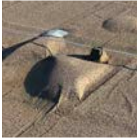
Sanierungsbedarf von feuchten Altdächern
